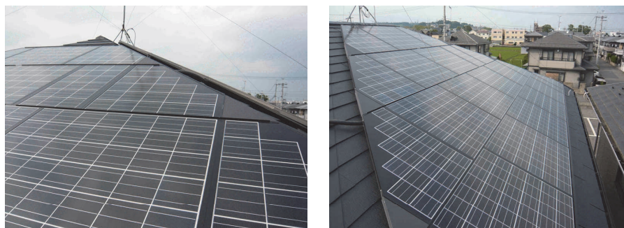
図2 設置した太陽光発電パネル（南西側 1.687kW、南東側 2.736kW、計 4.423kW）
