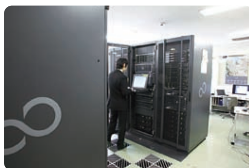
電算機室 Servers Room
